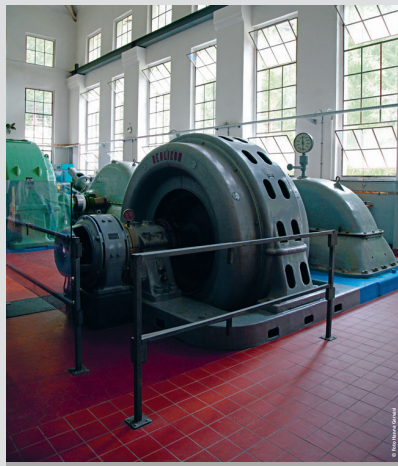
Arosa, Kraftwerk Lüen
